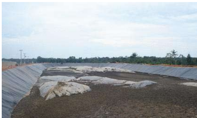
Figura 01. Ascensão de gases não prevista em projeto, causando a elevação da geomembrana.
