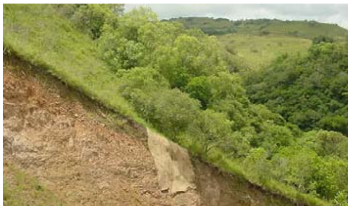
Figura 01. Erosão em talude desprotegido.
