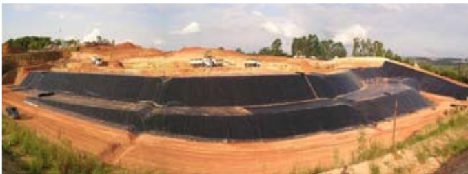
figura 3 - Aterro sanitário revestido com geomembrana.
