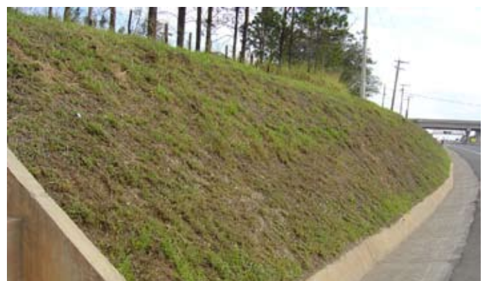
Figura 03. Vegetación crecida sobre el talud revestido.
